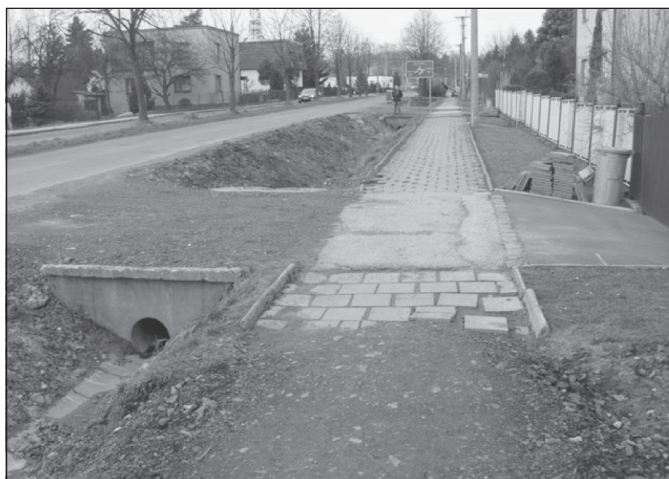
Chodníky před opravou...
