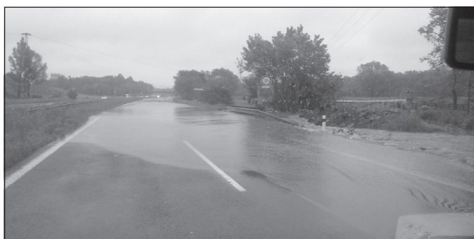
Silnice I/11 - Ostravská – směr Havířov
