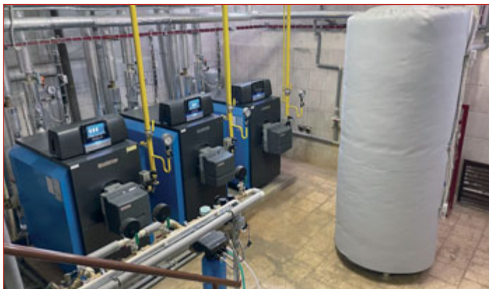
Kotelna Trlicova po modernizaci.
