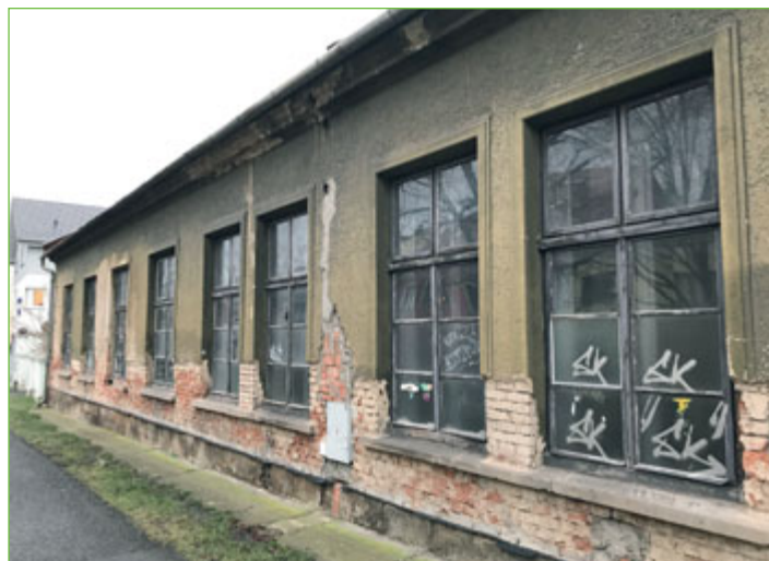
Zchátralá budova, místo chodníku mech a oprýskaný beton.
