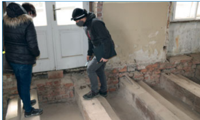
Kontrola rozsahu napadení trámů v 1. patře vily Augusta Hückela.
