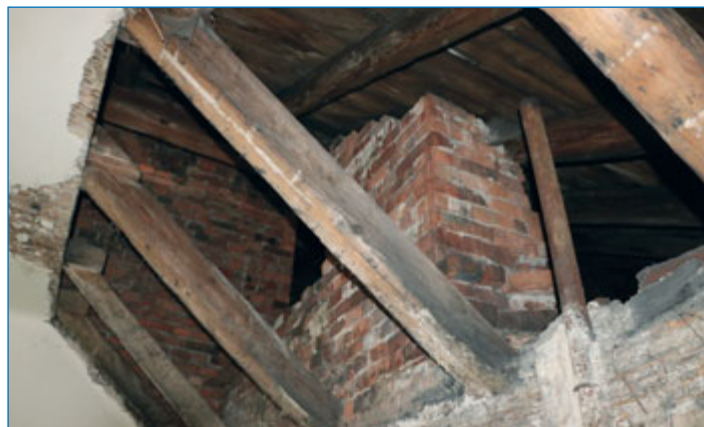
Silně poškozené krovňí části dřevomorkou zjištěné po odstranění omítkových vrstev.
