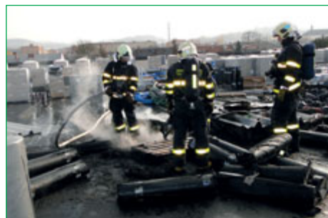
■ Na střeše krytého bazénu hořelo.
