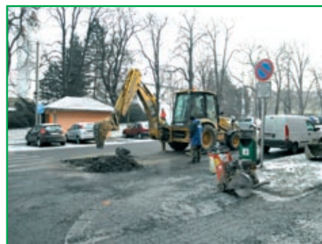
■ Závada na vodovodu na Tyršově ulici.
