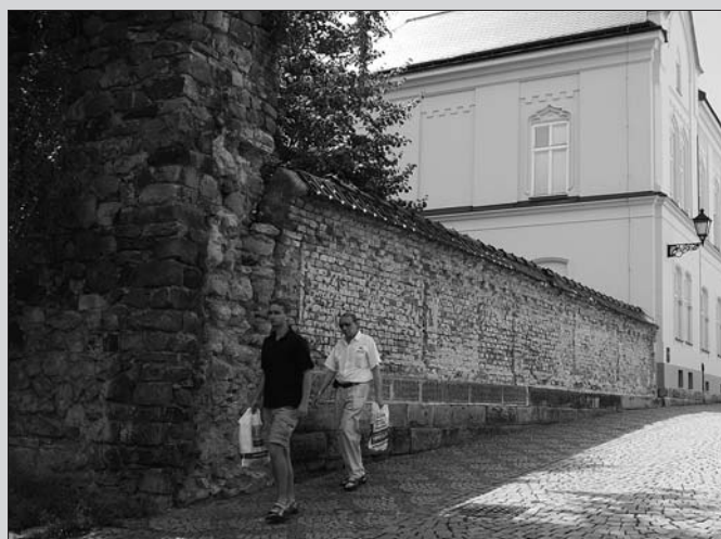
Farní zeď v centru Nového Jičína bude brzy opravena.
