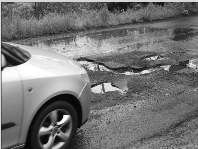
Na některých místech je silnice z Nového Jičína přes Skalky a Čerták do Kojetína ve velmi špatném stavu.
