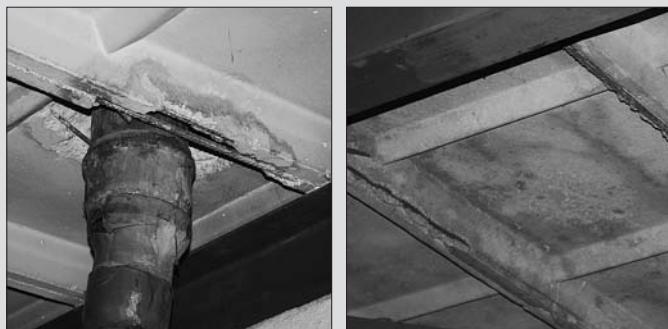
Detaily rezavějící části střechy krytého bazénu.
