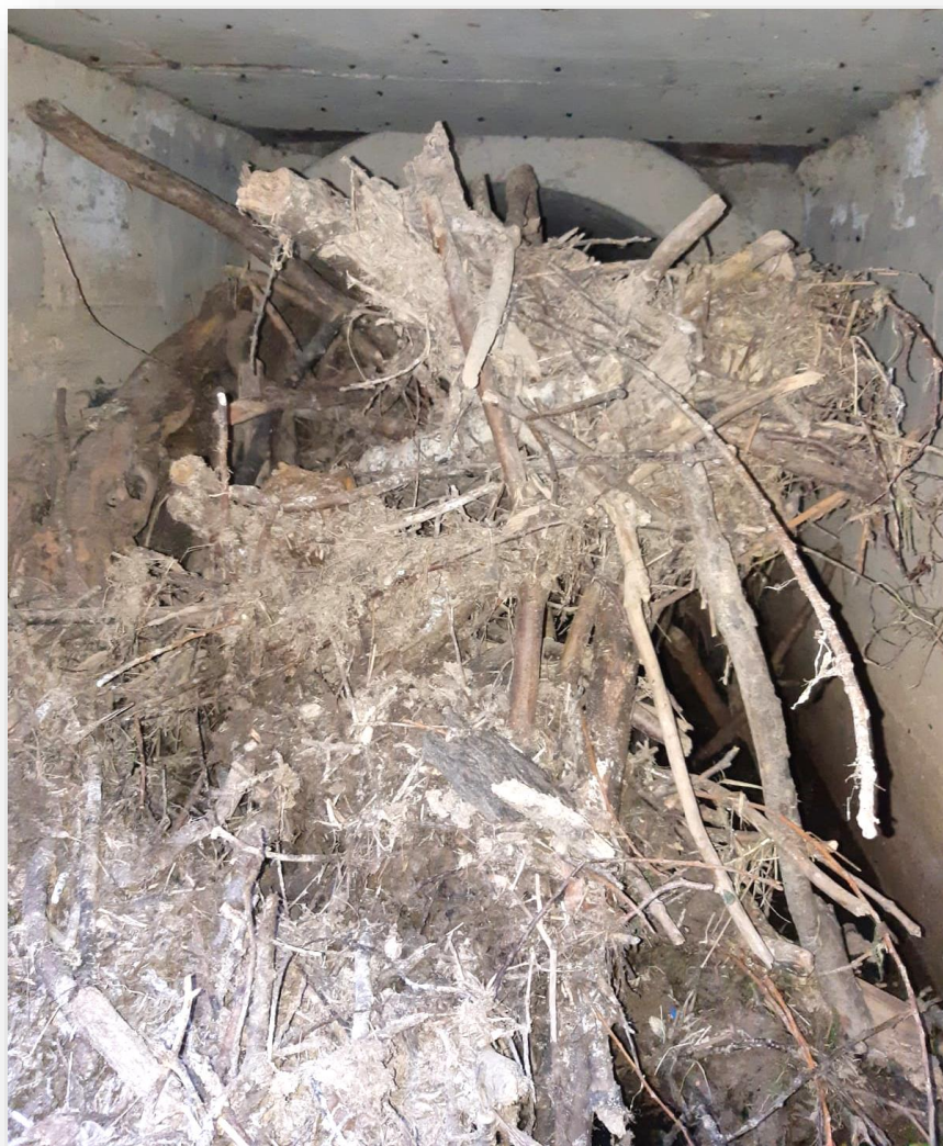
Naplaveniny v zatrubněné části Choltického potoka.
