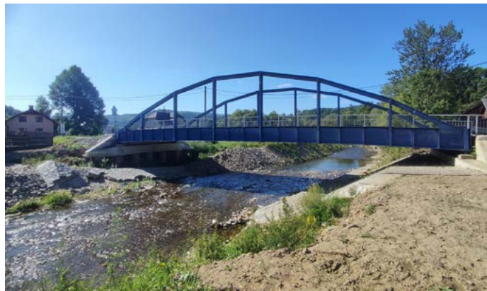
Most do Skrbovic voda vzala. Obloukový most, který spojuje horní a spodní část obce Široká Nivá je sice v provozu, ale je viditelně podemletý a potřebuje opravu. Foto: archiv
