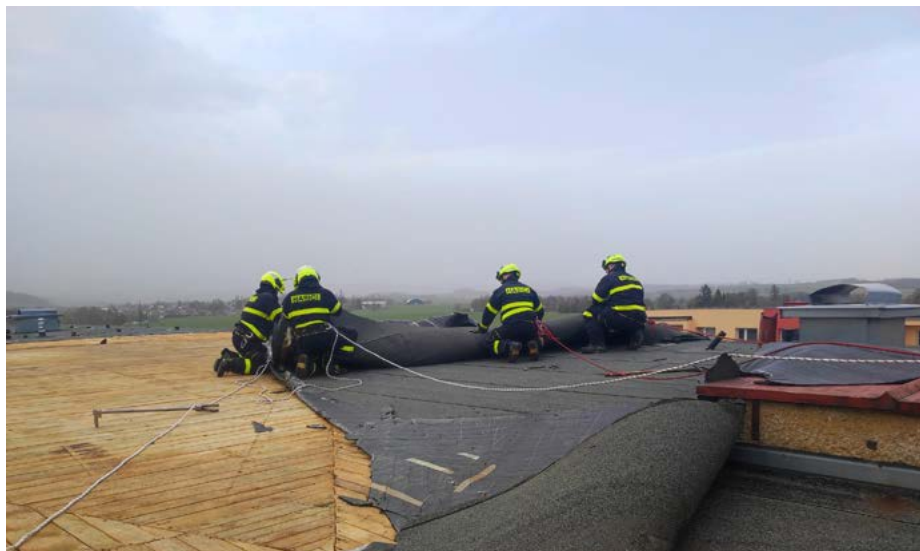
Přikrývání obnažených desek na střeše bytového domu hasičům komplikoval silný vítr.
