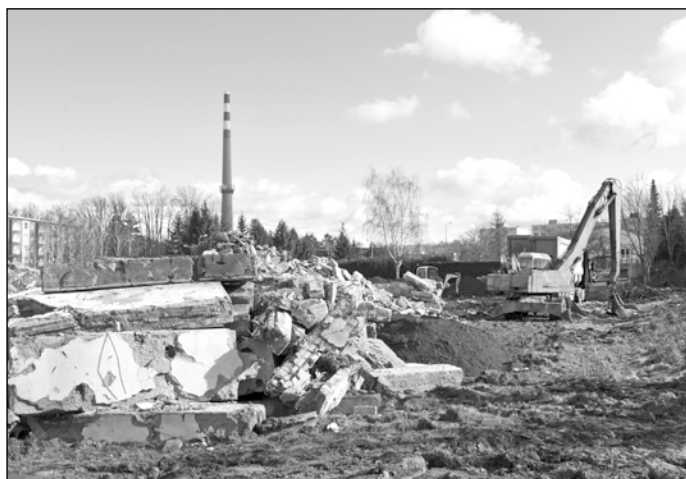
Z budov v areálu organizace Sagapo téměř nic nezůstalo. Na pozemku vyrostou nové domy. Foto: zup
