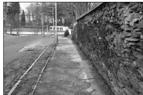
Chodník na Chelčického ulici je již léta v havarijním stavu, jeho oprava by mohla začít již brzy. Foto: zup
