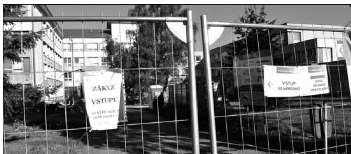
Pro návštěvy bruntálské nemocnice musejí návštěvníci využívat zadní vchod. Hlavní vstup je uzavřen kvůli probíhajícím opravám prostranství před nemocnicí.
