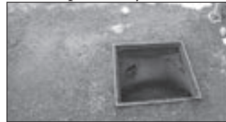
Chybějící víko kanalizace v Brožíkově ulici. Foto: Archiv
