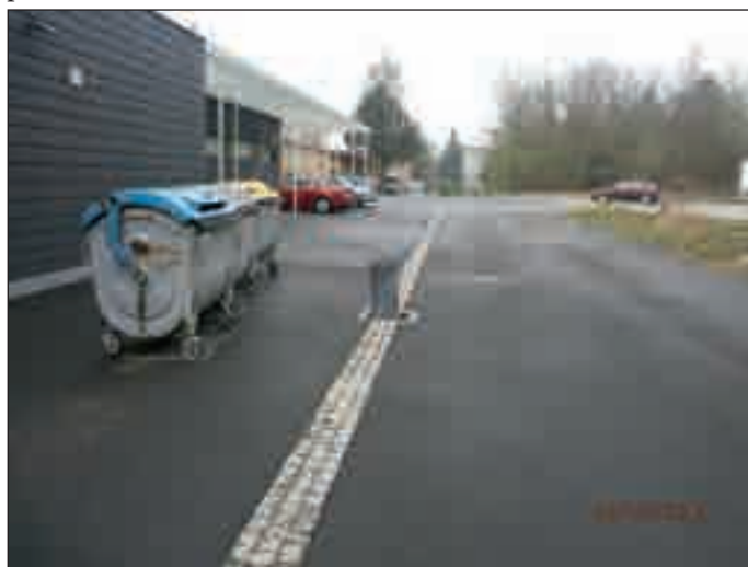
Díru po chybějícím poklopu na kanále v areálu nemocnice strážníci označili, aby nedošlo k nehodě nebo úrazu. Fota: MP Bruntál
