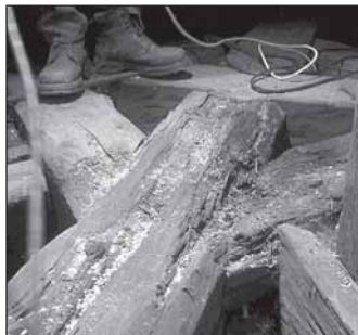
Dřevěné konstrukce věže jsou napadeny houbou. Statika věže je narušena.
