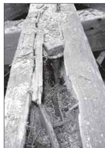
Poškozený trám staré věže.
