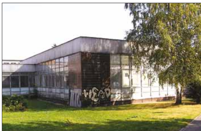
Současný stav budovy bazénu.
