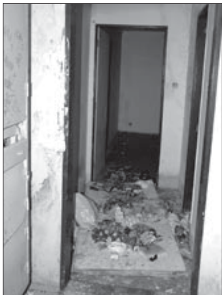
Snímek jednoho ze zdevastovaných bytů v Dlouhé ulici č. 18. Volně přístupných bytů bez dveří, plných odpadu a nepořádku, je v domě více.
