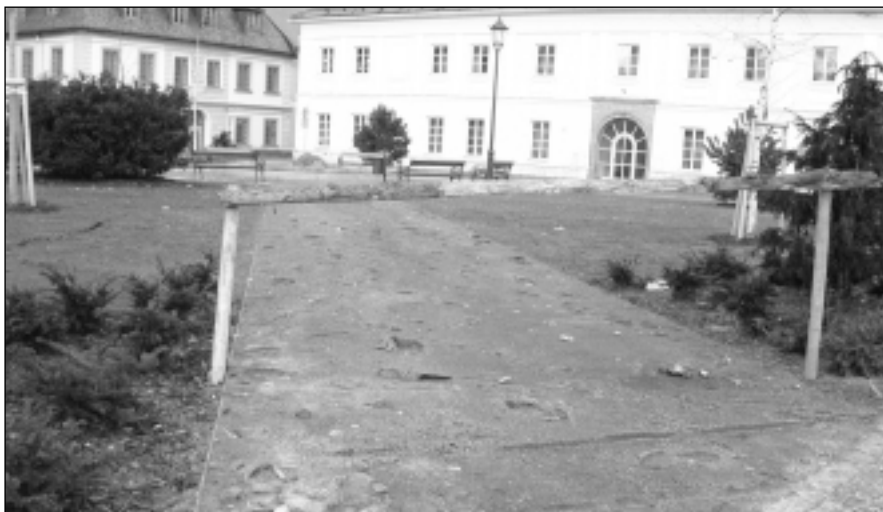
Vchod na mlatové chodníky na Zámeckém náměstí je v těchto dnech nepřístupný.
