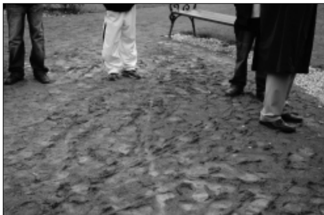
Povrch chodníku je velmi změkklý.
