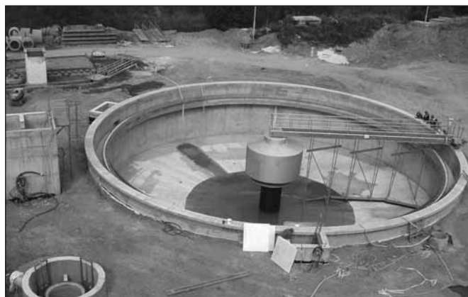
Rekonstruovaná čistírna odpadních vod v Bruntále splňuje nároky moderní stavby. Foto archiv JAST
