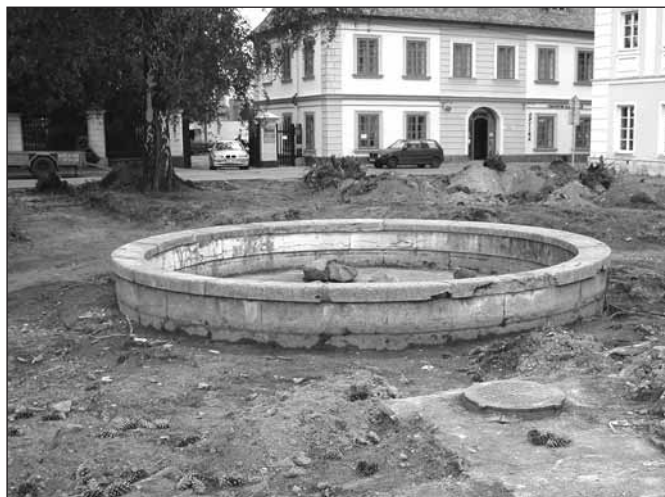
Původní poškozená kašna
