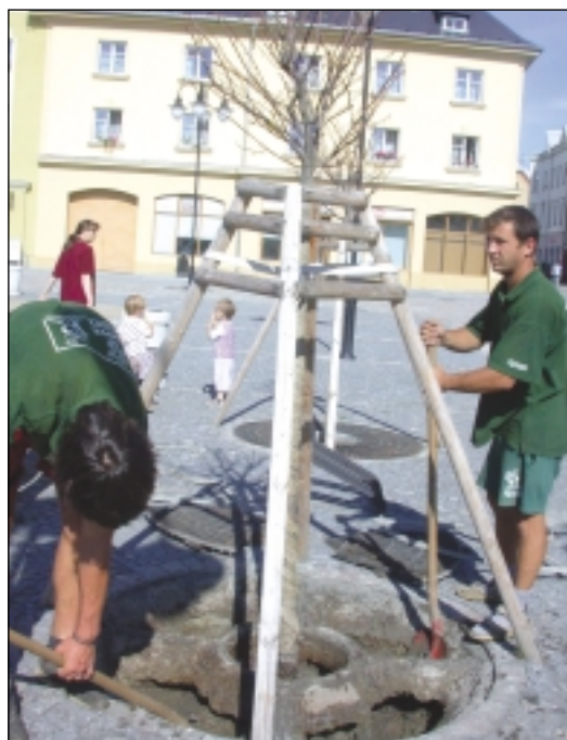
Na konci července byly na náměstí vyměněny stromy, kterým uhynuly kořeny, protože se v nich držela voda. (více na str. 5) Foto - mon-
