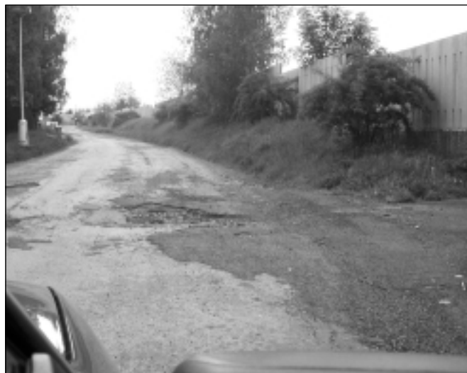
Až metrové díry v silnicích Jezdecká a U Stadionu snad brzy budou minulostí.
