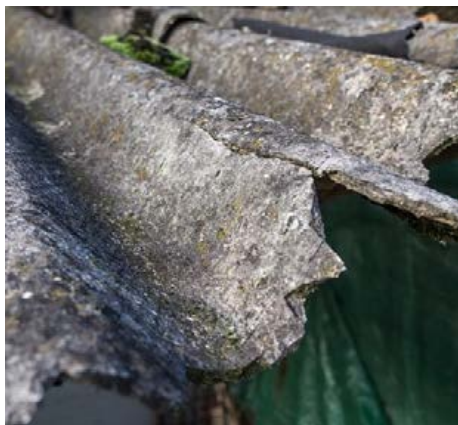
Při mechanickém poškození se uvolňuje prach s obsahem azbestu
