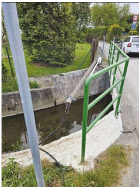
spadlý sloup s dráty
