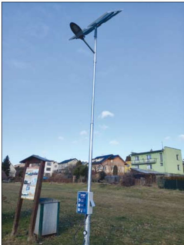
sloup s osvětlením, solárním panelem a nabíjecí stanicí pro elektrokola
