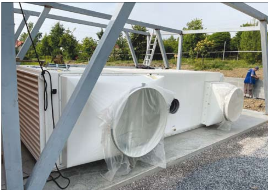
dieselažregát pro případ výpadku proudu
