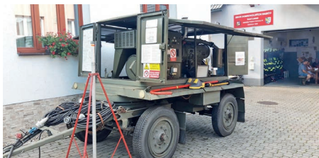
Foto elektrocentrály s výkonem 30kW
