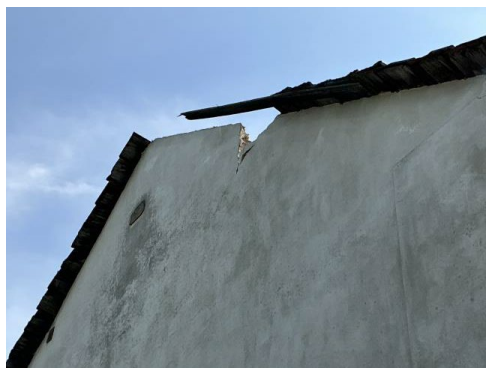
Detail poškození štítu
