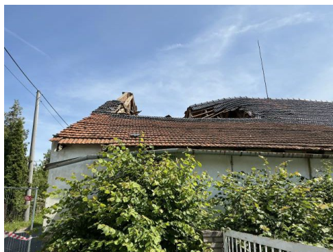
Detail poškození konstrukce
