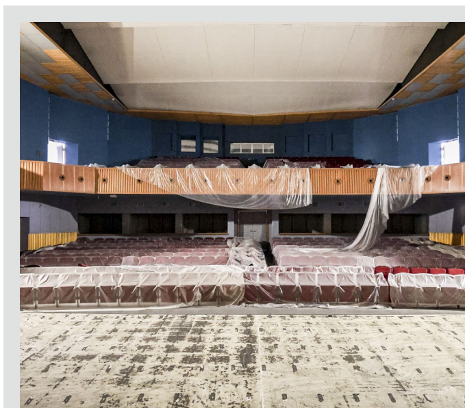
Při povodni voda zatekla i do hlediště, kde se bude muset provést úprava podlahy a vyměnit koberec.
