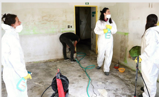
V budově MŠ Kaštánek v ulici M. Gorkého voda zatopila všechny sklepní prostory. Foto: Tomáš Gaudek
