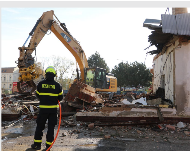
Povodeň natolik poškodila městský nebytový prostor na náměstí Minoritů, v němž dříve býval zverimex, že musel být tento týden stržen.
