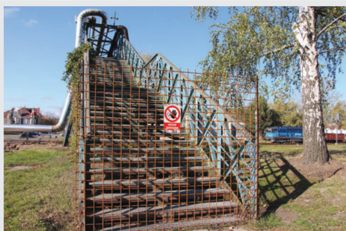
Lávku pro pěší nad železniční trati, která slouží už 110 let, čeká v příštím roce oprava. Foto: Dita Círová
