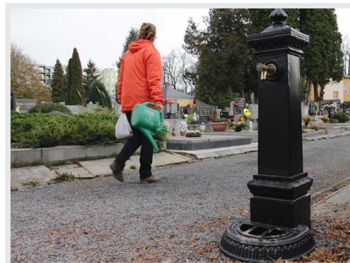
Součástí nového vodovodu na hřbitově jsou ozdobné litinové výtokové stojany.
