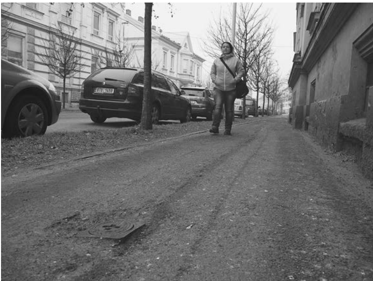
Zastupitelé napříč politickým spektrem budou do rozpočtu prosazovat opravy chodníků a místních komunikací, například chodníku na Hlubčické ulici (na snímku).
