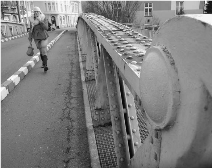
Město v letošním roce zrekonstruuje historický ocelový most přes řeku Opavu, na němž je kvůli špatnému technickému stavu už sedm let omezena doprava.
