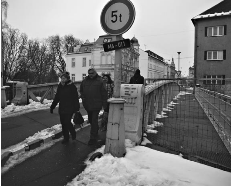
Na historickém ocelovém nýtovaném mostě přes řeku Opavu je už šest let omezena doprava.
