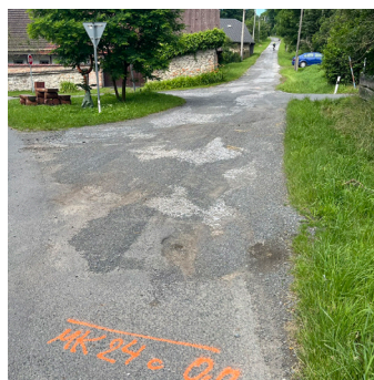
Mnohé cesty v obci se nacházejí v dezolátním stavu. Foto: Kryštof Vyleťal
