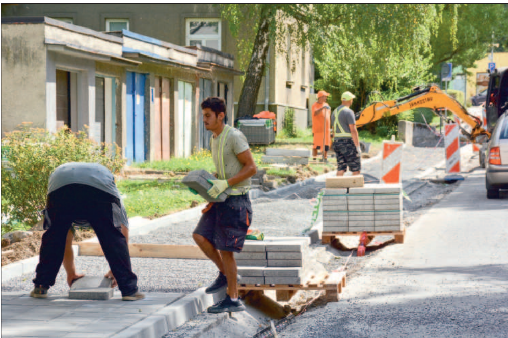
Stavba nových chodníků na ulici Dukelské má být dokončena do konce srpna. V některých úsecích stavby je už ale prováděcí firma v prodlení. Důvodem prodloužení realizace je nekvalita prací. Město coby objednatel nechalo chodníky v některých úsecích dokonce i několikrát předlážit, protože tak, jak je realizační firma postavila, neodpovídaly předepsaným normám. FOTO: D. MACHÁČEK
