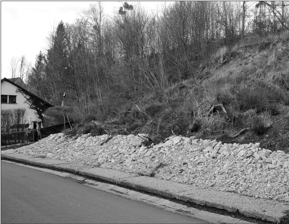
Provizorní zpevnění sesutého svahu v Lubině bylo provedeno na náklady města. Radnice se ale dále v sanaci svahu angažovat nebude.
