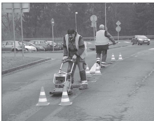
Výkyvy počasí způsobily velké množství výtluků na silnicích. Opravy se však mohou provádět jen v plusových teplotách. FOTO: D. MACHÁČEK
