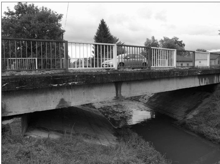
Oprava chátajícího mostu na ulici Severní je největší investiční položkou v nově schváleném rozpočtovém změně. Zastupitelé na rekonstrukci vyčlenili 7 milionů korun. FOTO: D. MACHÁČEK
