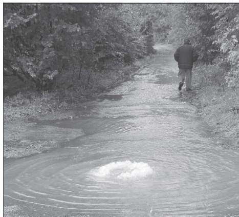
Někteří obyvatelé Lubiny vypouštěli dešťovou vodu do splaškové kanalizace, což způsobilo zahlcení přečerpávací stanice. Hned vedle ní vyvěrala voda z poklopu kanálu.
