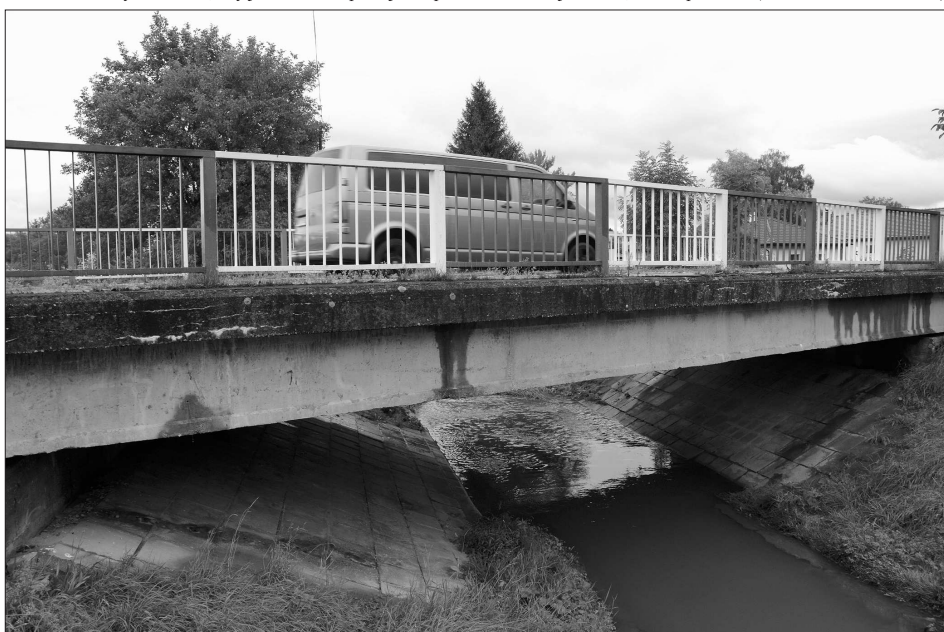
Stav řady mostů ve vlastnictví Kopřivnice není dobrý. Tomu, který se klene přes koryto Kopřivničky na ulici Severní, dokonce kvůli technickým vadám výrazně snižují povolené zatížení.
