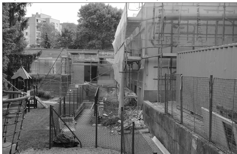
Budova Materské školy I. Šustaly zůstane díky zjištěným trhlinám ve zdech stavenišť o něco déle, než se původně předpokládalo.
